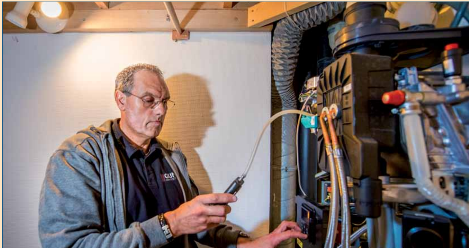
Inspectie van een cv-ketel door een installateur. UNETO-VNI, de ondernemersorganisatie voor de installatiebranche, wil dat iedere installateur aan dezelfde vakbekwaamheidseisen moet voldoen om de veiligheid van gasinstallaties te verbeteren. Foto: Frank de Roo/HH
